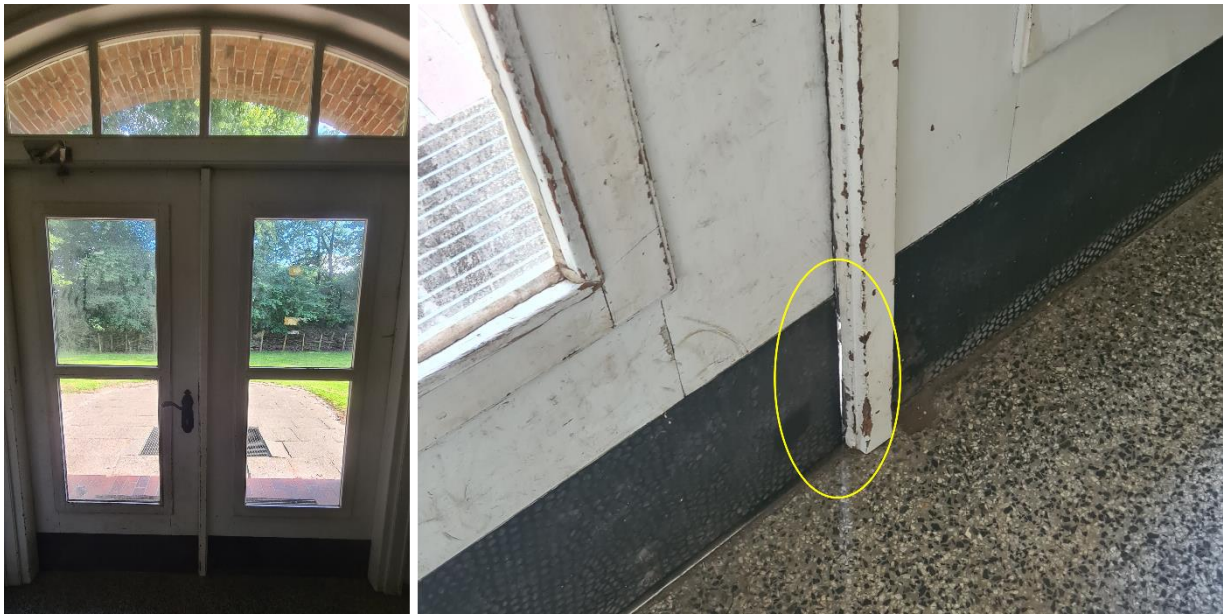
Abbildung 4-18: Eingangstür am Portal mit deutlichem Spalt (rechts)
