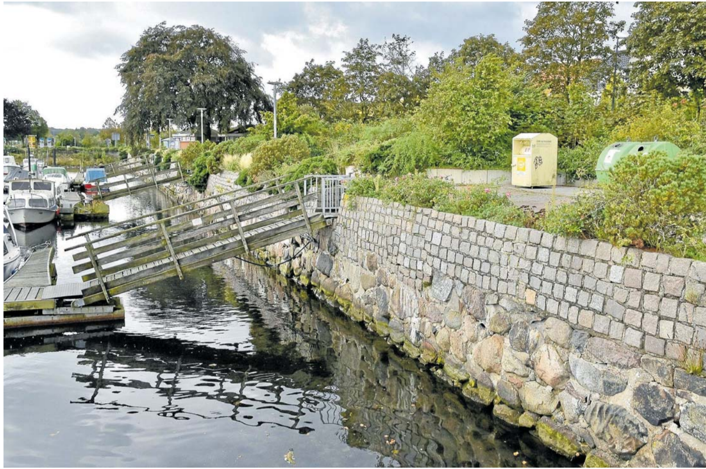
Erst muss die marode Spundwand samt Kaimauer saniert werden, dann kann die neue Promenade an der Gaethjestraße folgen. In der großen Variante ist auch ein Wassersteg vorgesehen.
